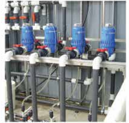
40 GPM Install (Zwart Systems)
